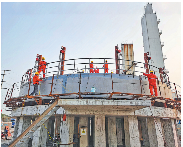
▲广西来宾海湾空气气体有限公司空分储罐项目部在抓好疫情防控的同时组织员工复工复产。
