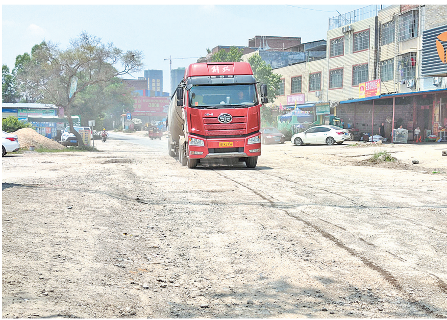
▲柳来路部分路段坑坑洼洼。
