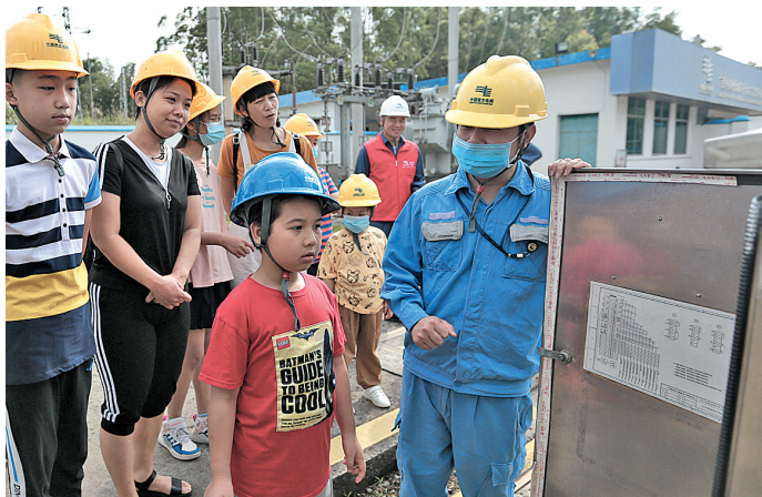
供电技术人员向前来参观的家属和小朋友介绍供电情况。
