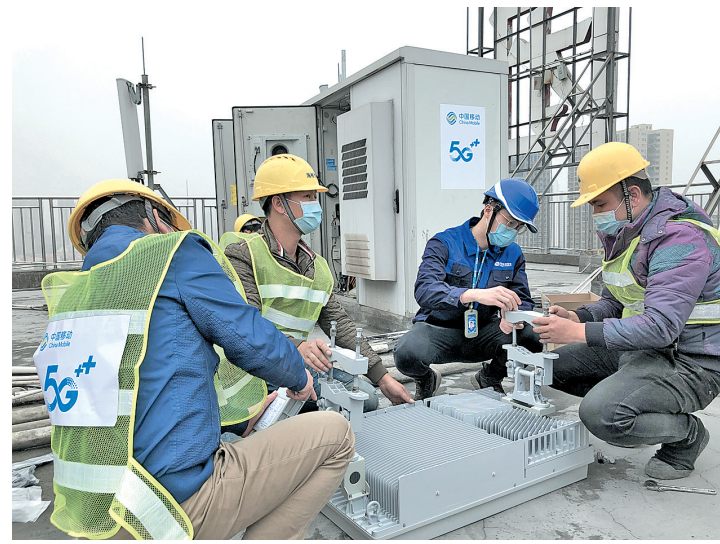
▲目前，来宾移动建成开通5G基站近200个，率先完成来宾核心区城区的连续覆盖，5G客户超10万户。未来三年，来宾移动还将在全市投入超3亿元建设超过600个的5G基站，计划2022年实现乡镇以上全覆盖、农村热点全覆盖，完成全部高铁5G覆盖。图为来宾移动工作人员在5G基站现场施工。(谭淑丹 摄)
