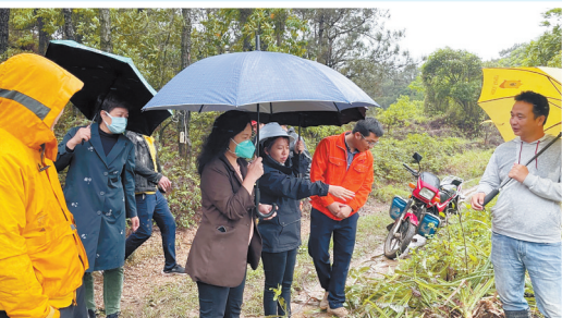
2022年4月1日,市特派办要素组工作人员到广西长科公司110kV供电线路施工现场详细了解项目推进过程中的存在问题,同时与企业负责人积极沟通并提出解决措施。
