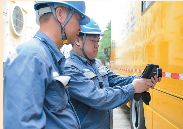
▲在来宾二中考点,南方电网广西来宾供电局供电服务班工作人员在给发电车测温,为高考供电保驾护航。(周宇 摄)
