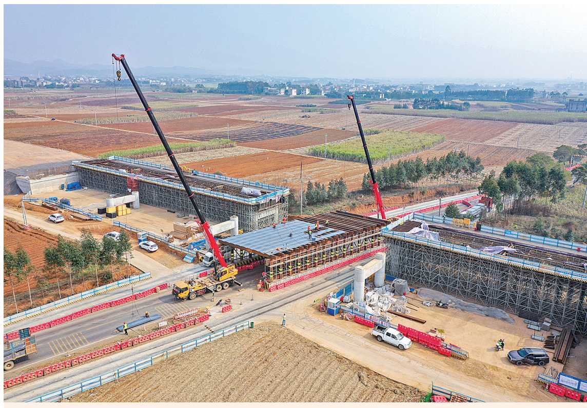
▲2月23日,位于武宣县二塘镇渠盖村附近的武忻高速建设现场,工人在紧张有序地施工。武忻高速起点位于二塘镇渠盖村附近,连接柳武高速,途经武宣、兴宾、合山和忻城,终点位于忻城县古蓬镇板屯附近,连接正在规划中的宜上高速,主线全长119.2公里。(李干金 胡佳坤 摄)
