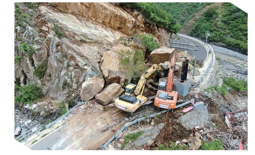
▲8月6日,在北京市房山区史家营乡金鸡台村附近,北京建工机械集团的大型机械设备在清理阻断道路的落石(无人机照片)。当前,北京正努力复通山区道路。新华社发
