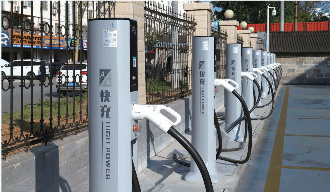
▲新“上岗”的快速充电桩。
