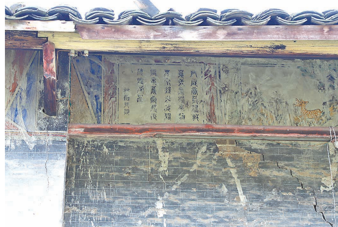
▲外墙壁画已被破坏。
