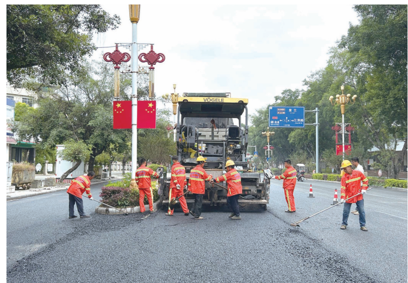
▲11月10日，合山市人民中路维修工程全线完工，平坦的沥青路面让人眼前一亮。据了解，该工程是合山市城市更新城中片区改造项目的一部分，维修路段从光热小区出入口至合山市公安局，全长1024米。项目改造完成后，可有效改善市民通行条件，消除道路安全隐患。图为项目施工现场。(钟景湘 摄)
